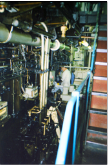
Het tussenbordes met de brandstofpompen en de cilindersmeerapparaten.
