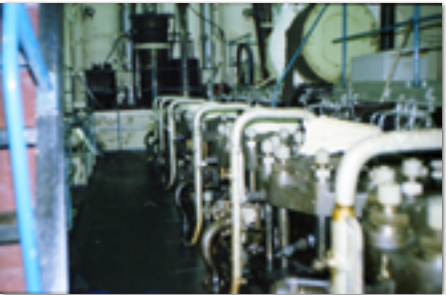
Het koppenbordes met een van de twee turbo's. Tegen het machinekamerschot een reservevoering.
