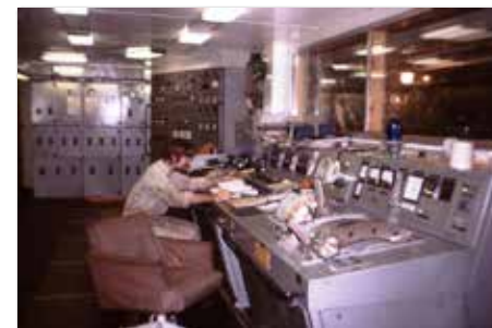
De controlekamer zag er redelijk uit al waren de consoles en de deuren van de schakelkasten niet helemaal strak.
